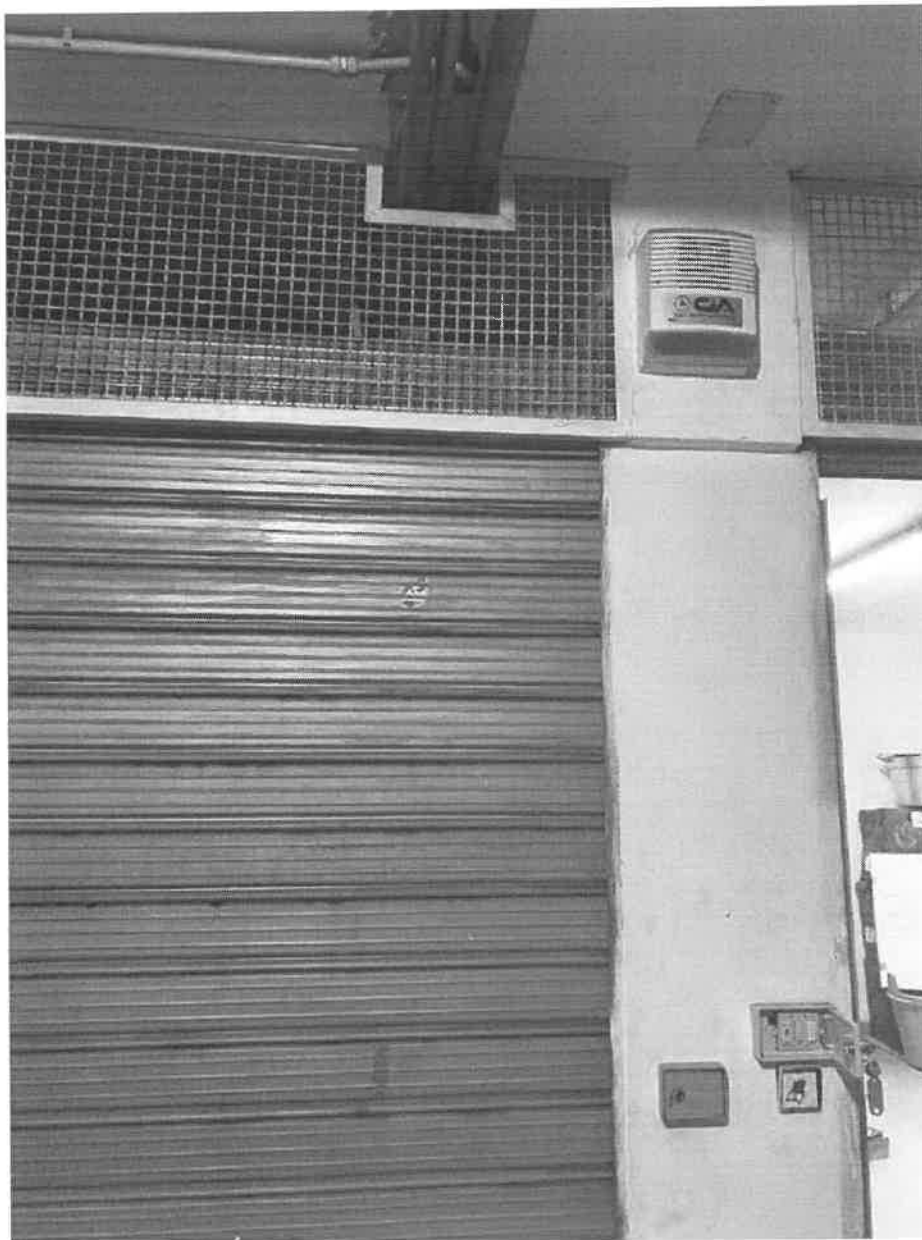
FOTO n. 5 – Particolare sistema di allarme box –
